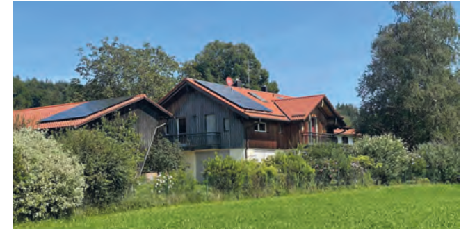
PV-Anlage in Monatshausen
