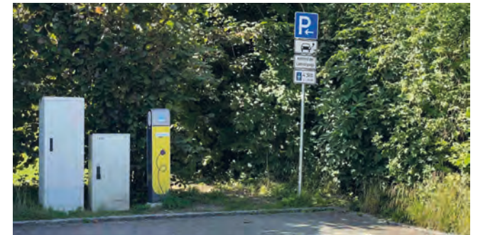
Ladestation für Elektrofahrzeuge an der Kirchenstraße
